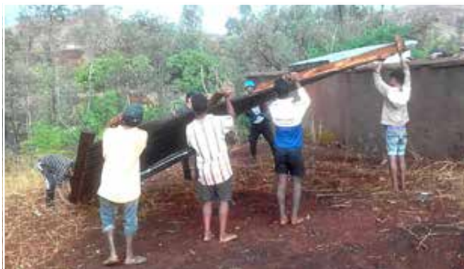
Zerwany przez cyklon Ana dach w Collège Mampitsoa.
