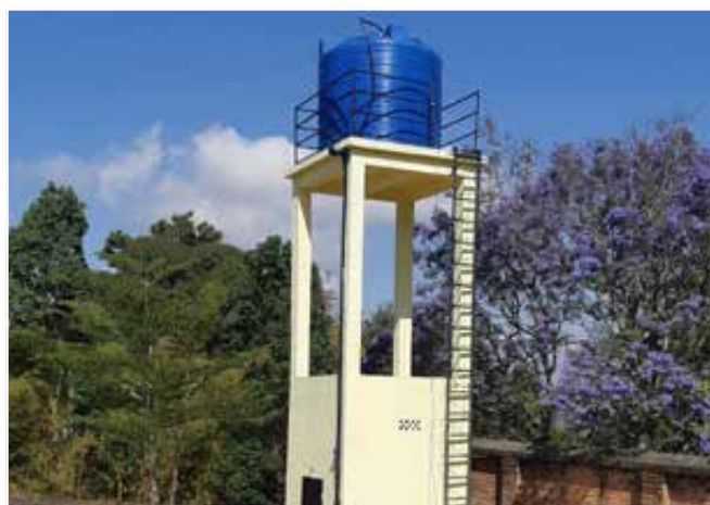
Wieża ciśnienia wykonanej studni głębinowej i wodociągu dla Marany.
