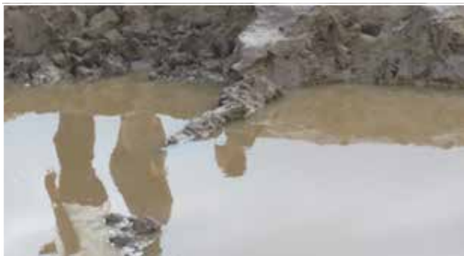
W dystrykcie Chikwawa główna droga została poważnie uszkodzona.
