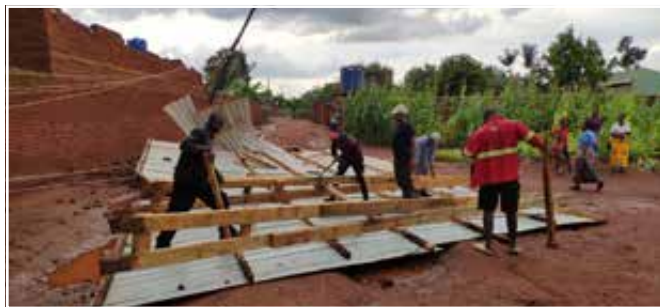
Szkody spowodowane przez wichurę.
