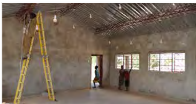
Instalacja elektryczności w budynku szkolnym.
