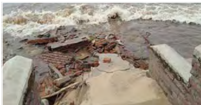
Uszkodzenia przy brzegu jeziora Malawi.
